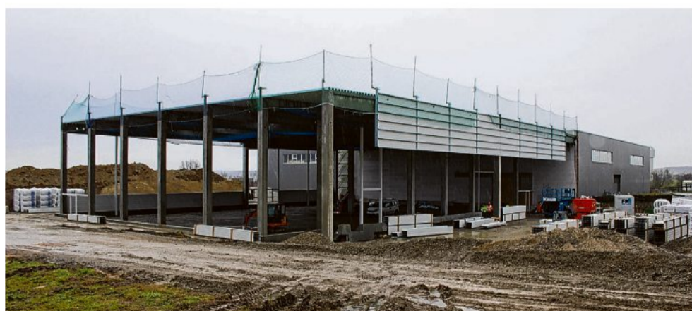
Investition: Sechs Millionen Euro lässt sich das Unternehmen den 1700 Quadratmeter großen Bau kosten. Im nächsten Sommer soll er in Betrieb gehen.
